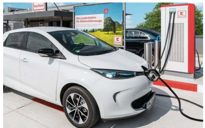
Abb. 4.6 E-Ladesäule auf einem Kaufland-Parkplatz, Quelle: Kaufland
